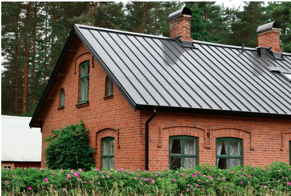
Bild 6. Exempel på byggnadsintegrerade solcellsmoduler i form av tunnfilm på plåttak. Fotograf: Midsummer Wave.
