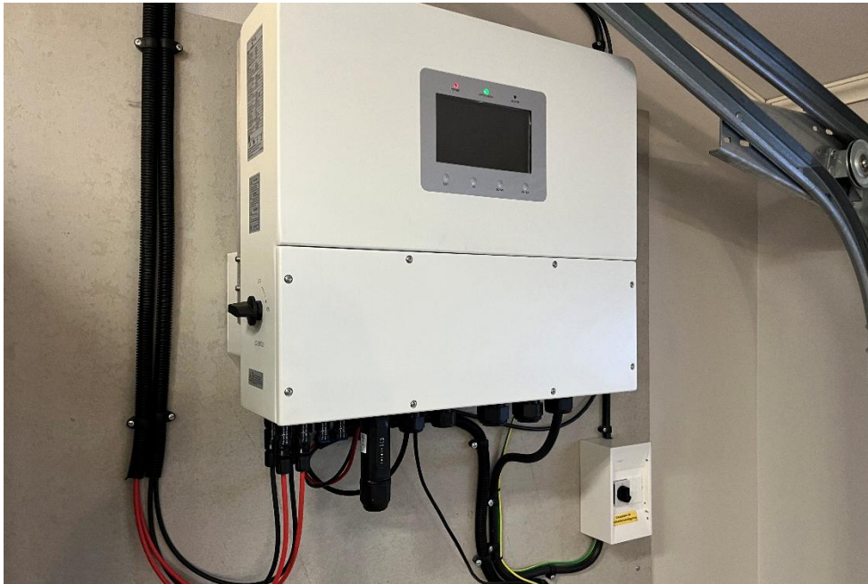
Bild 12. Exempel på likströmbrytare integrerad i växelriktare med reglaget utanpå, till vänster. Fotograf: Myndigheten för civilt försvar.
