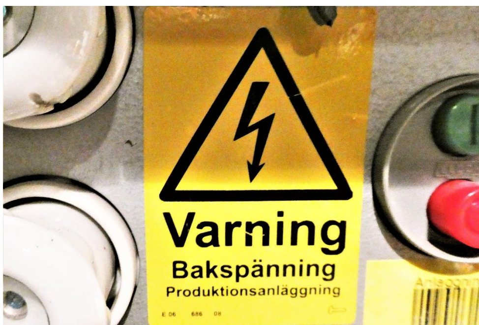
Bild 17. Exempel på varningsskylt för bakspänning. Fotograf: Myndigheten för civilt försvar.
